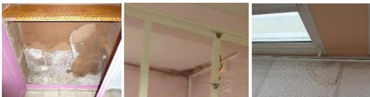
Figure 18. Exemples de signes d'humidité dans les salles de classe de la campagne « écoles ».
